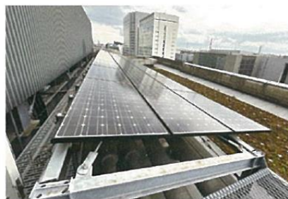
太陽光パネル
