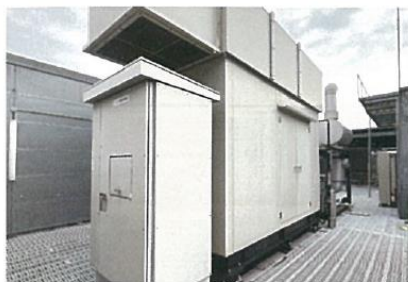
非常用発電機
