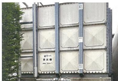
受水槽での貯留
